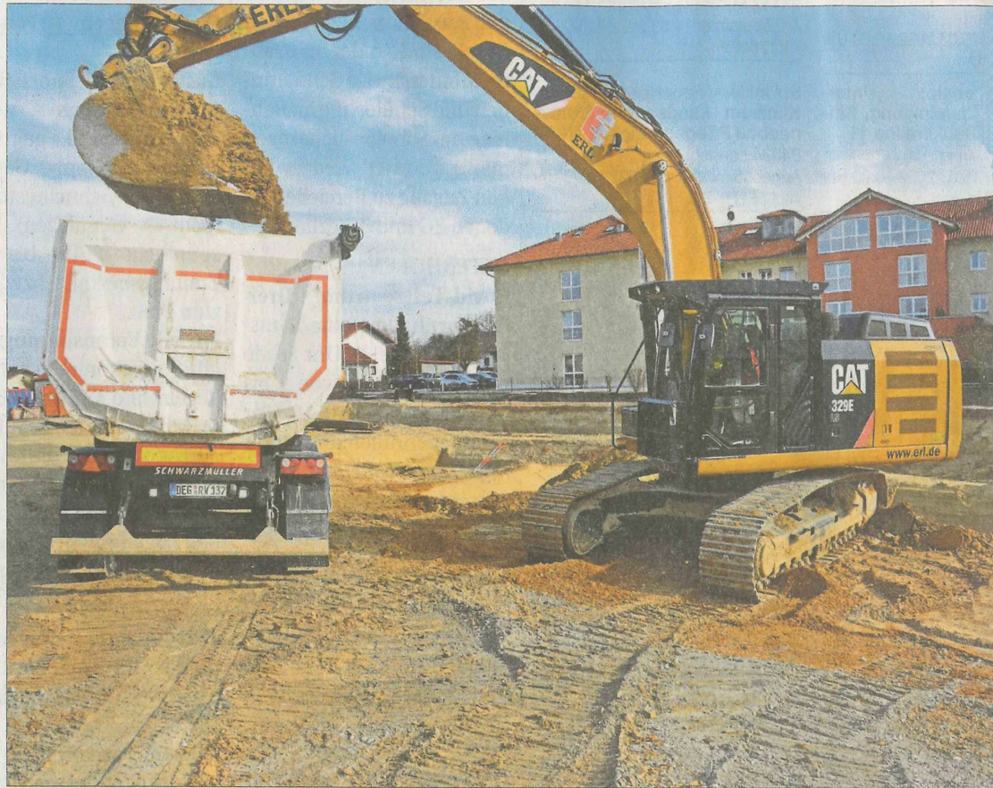
Ein Bagger schaufelt an der Piechlerstraße den Aushub für das Projekt zum betreuten Wohnen der Firma Erl auf einen Lkw. Ein Teil des Grundstücks ist für das Wohnheim der Lebenshilfe reserviert. – Foto: Schiller
